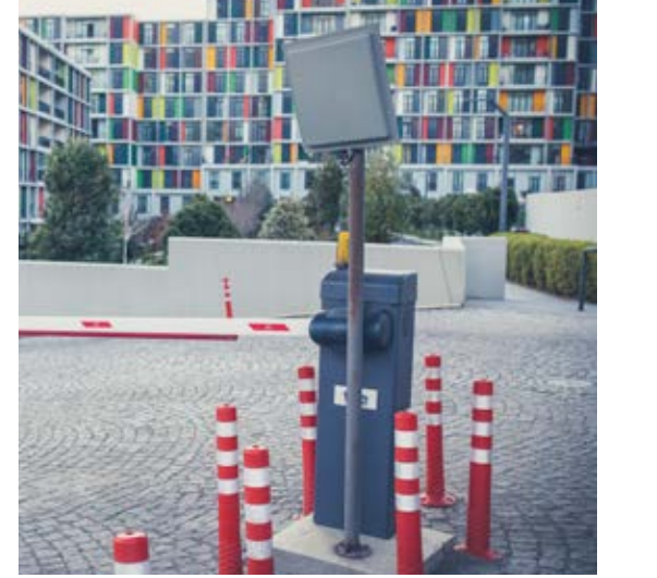
Hızlı Geçiş Sistemleri
